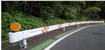
ガードレール
